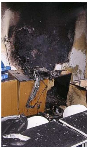
Obrázek 31. Důsledky nevhodného umístění elektrického spotřebiče na hořlavé podložce
