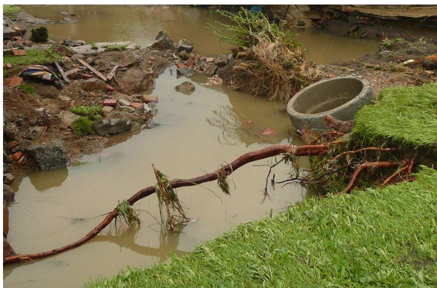
Obrázek 16. Následky bleskové povodně
